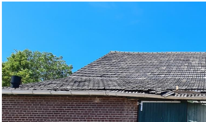
Figuur 11: Westelijke dakhelling van de woonboerderij, welke tegen de dakrand gedeeltelijke is ingestort
