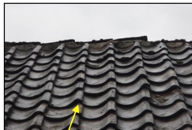
Figuur 10. Scheef liggende dakpannen met opening.
