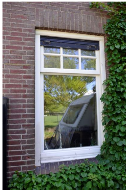
Venster in rechterzijgevel
