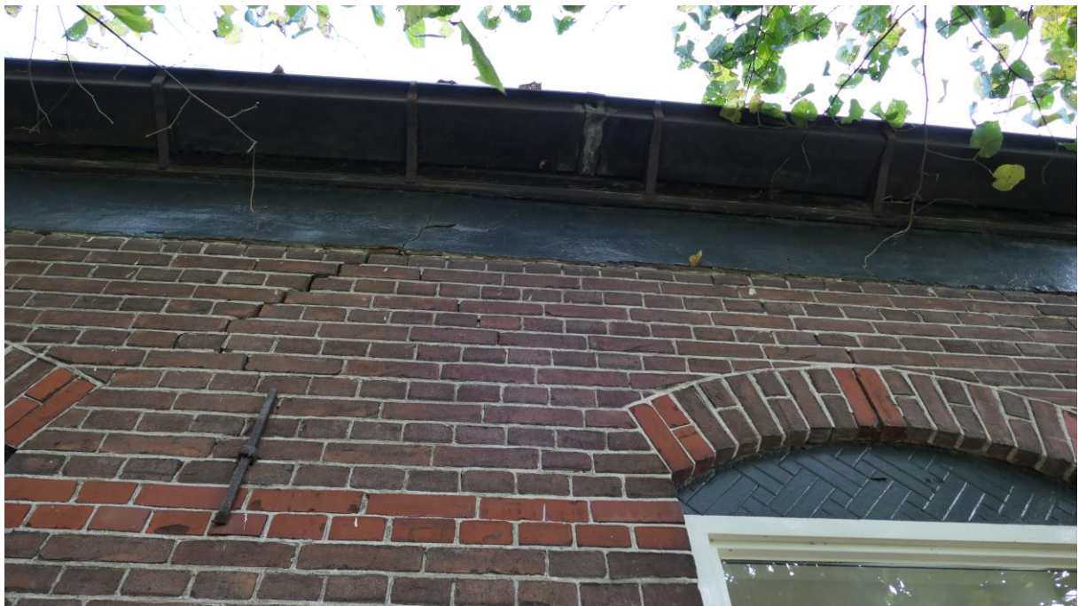
Figuur 4.6 Scheuren in de woning geven vleermuizen toegang tussen de muur.
