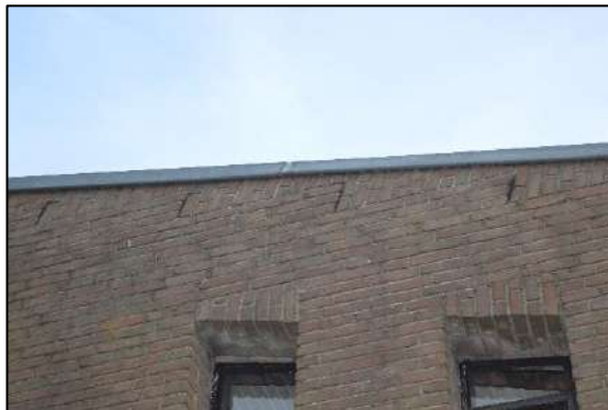
Afbeelding 3.1. Open stootvoegen kerkgebouw.
