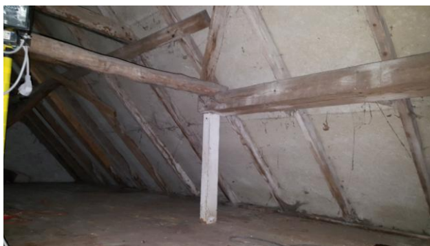
Zolder boven leefgedeelte met asbest dakbeschot
