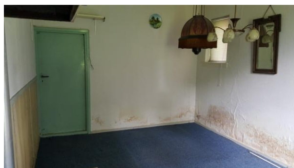
Slaapkamer in aanbouw met optrekkend vocht
