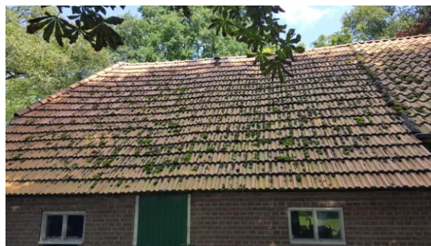
Dak achterdeel met verzakkingen door verrotte dakconstructie
