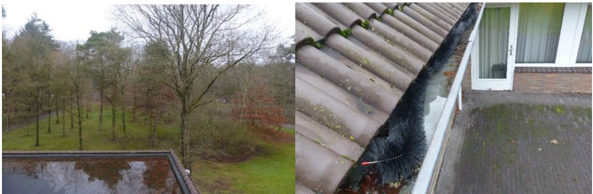
Figuur 15. A: platte dak van het zwembad blijft water staan.
