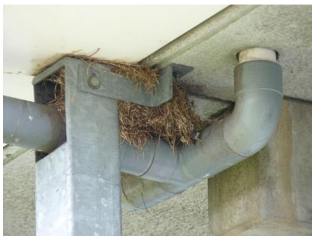
Figuur 10. A: Een nest op de regenpijp onder een balkon in het te behouden kamergebouw.
