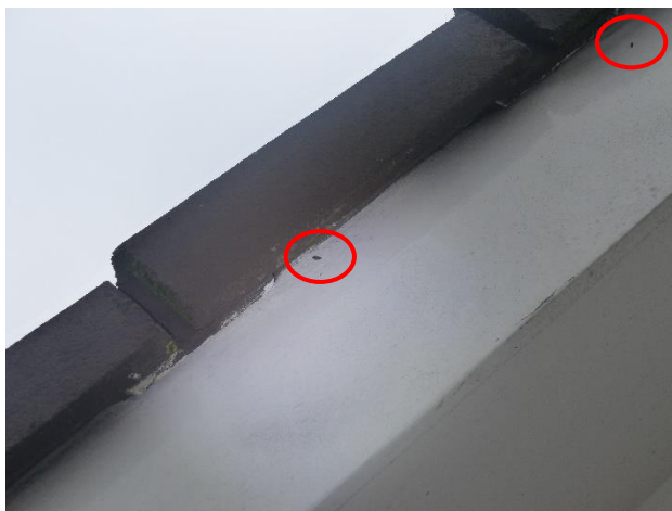
Foto 6 A: Keutels onder de gevelpannen
