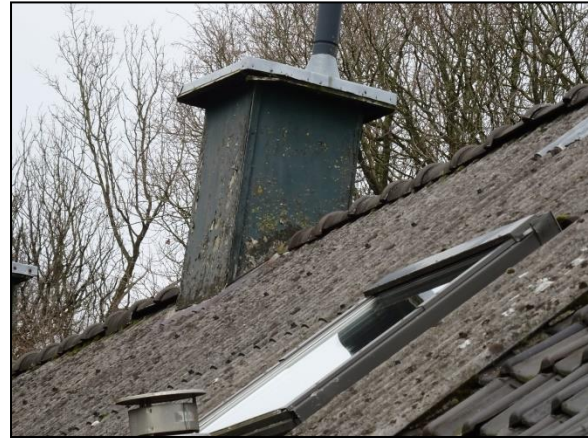
Figuur 17. Ruimte tussen nokpannen en dakplaten.
