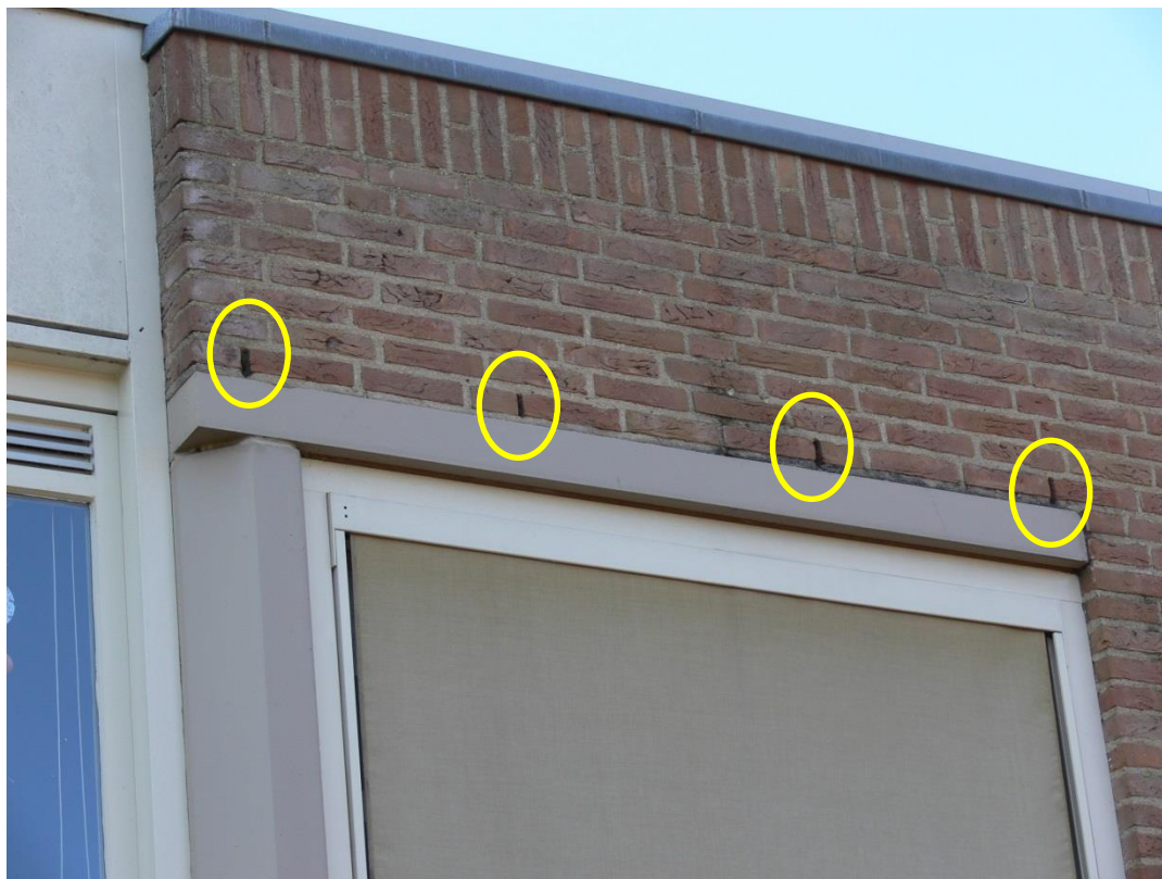
Figuur 2 Voorbeeld van open stootvoegen boven een raamkozijn, geel omcirkeld.
