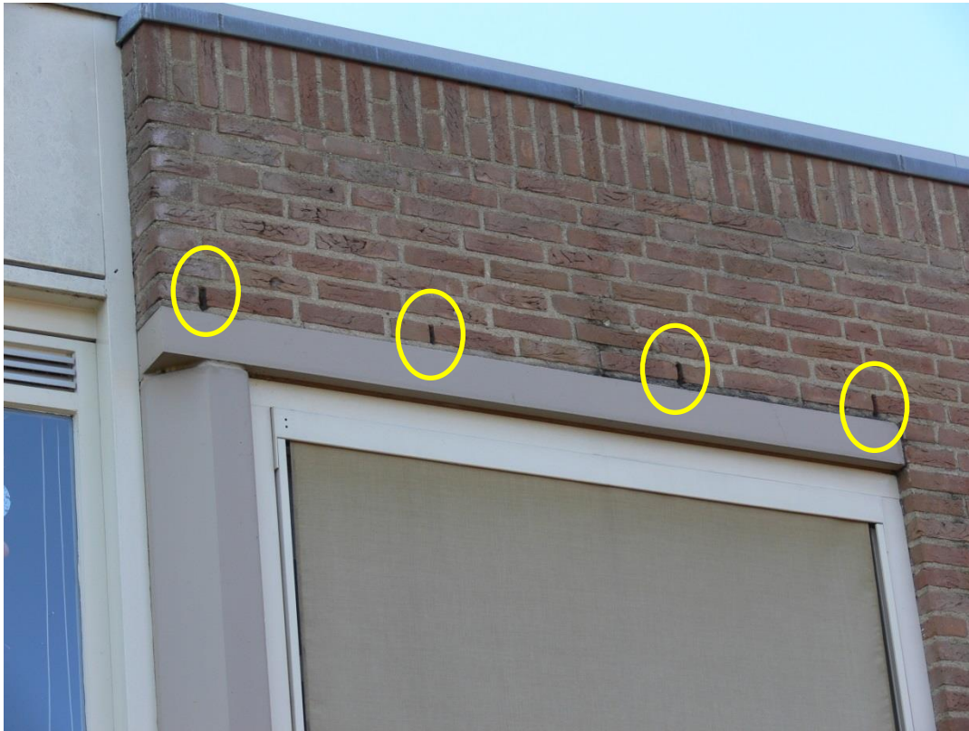
Figuur 3 Voorbeeld van open stootvoegen boven een raamkozijn, geel omcirkeld.
