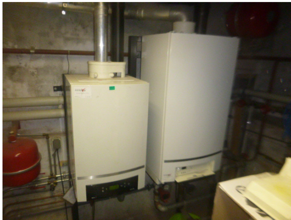
Cv-ketels niet asbestverdacht
