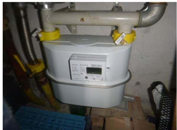
Gasmeter niet asbestverdacht
