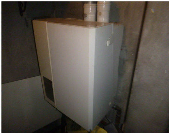
Cv-ketel niet asbestverdacht
