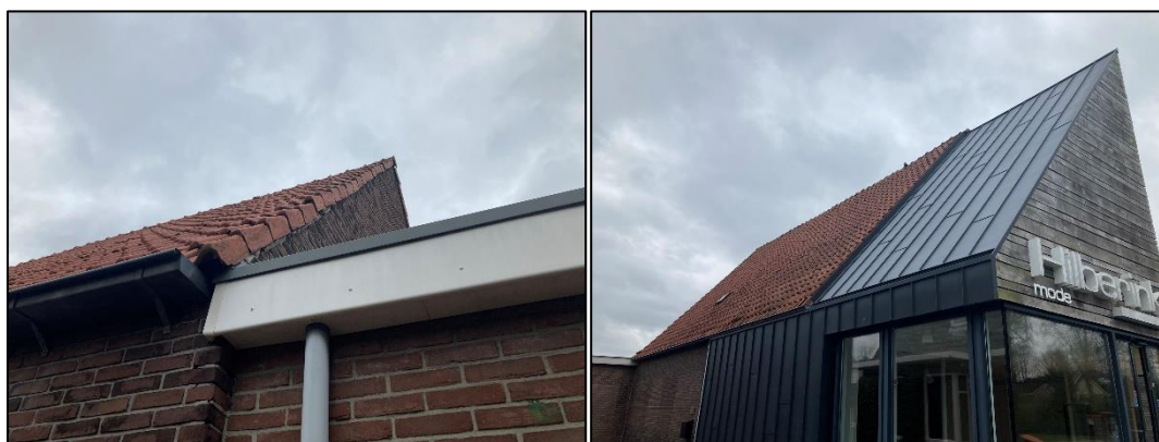
Figuur 2.5 (links): Impressie van het pannendak met loszittende pannen gezien vanaf de zuidwestelijke kant; Figuur 2.6 (rechts): Totaalimpressie van het zadeldak.
