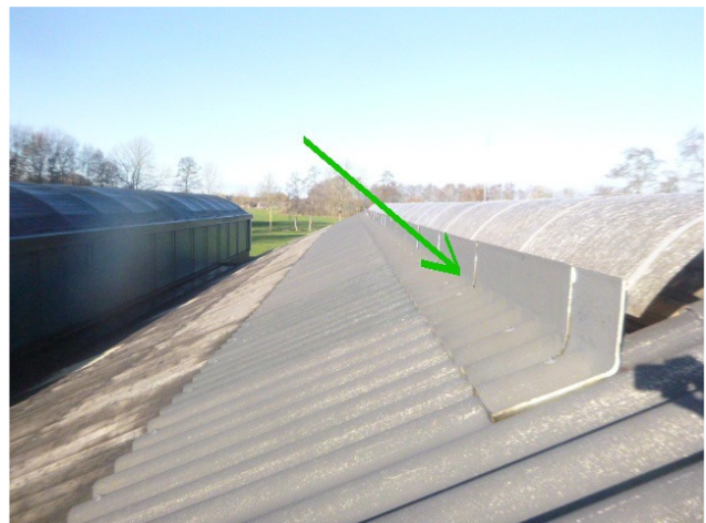
NT-ventilatiestukken kunnen als asbestvrij worden afgevoerd
