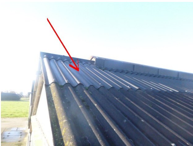
NT-golfplaten als asbesthoudend afvoeren
