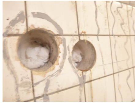
Tegels in cement
