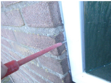
Inspectie kunststof kozijn
