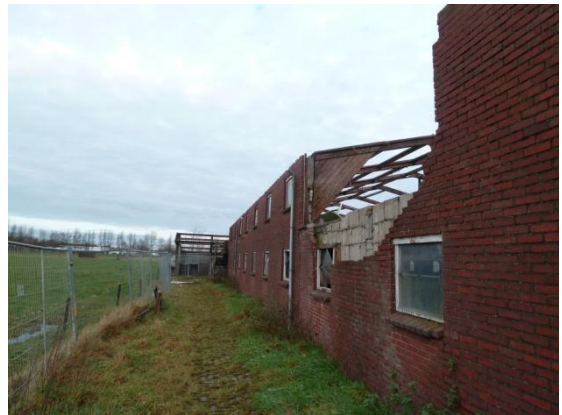
Afbeelding 2 de te slopen bebouwing is deels ingestort tevens is het dak verwijderd (Wierdenseweg 116).
