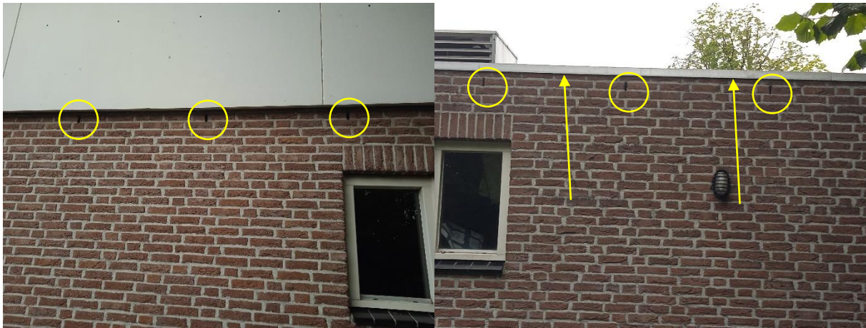
Foto links; zichtbare openstootvoegen vormen potentiële invliegopeningen in het gebouw (gele cirkels). Foto rechts; openingen onder de metalen daklijsten (gele pijlen) en zichtbare open stootvoegen (gele cirkels).
