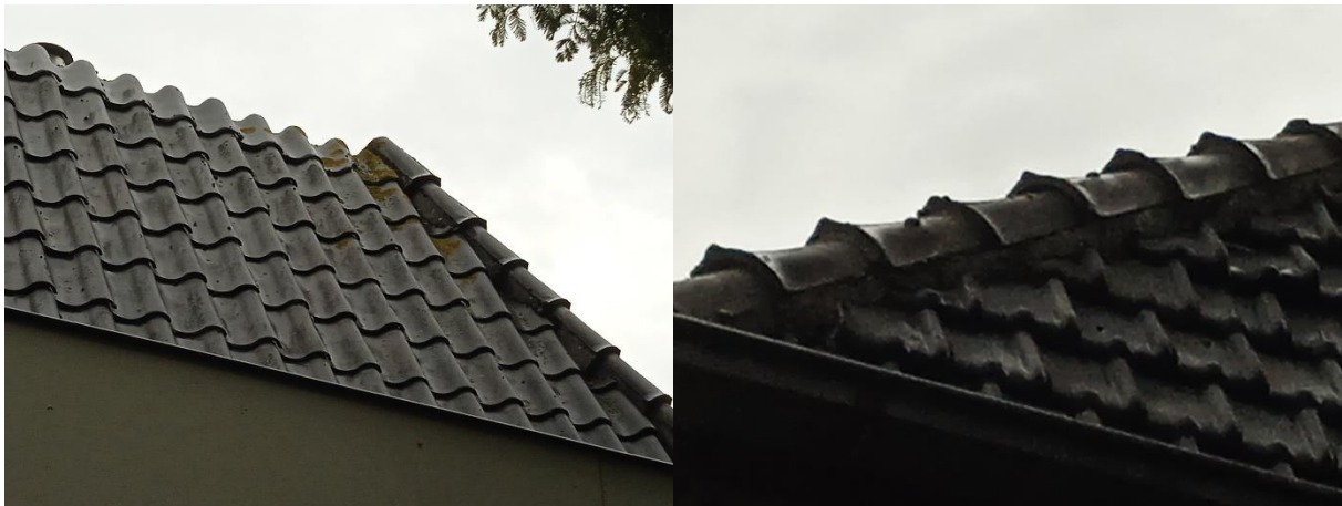
De nokpannen liggen in cement.
