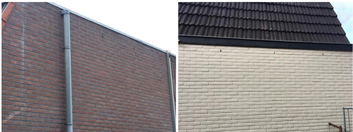
Open stootvoegen in buitengevels vormen en potentiële invliegopening voor vleermuizen.
