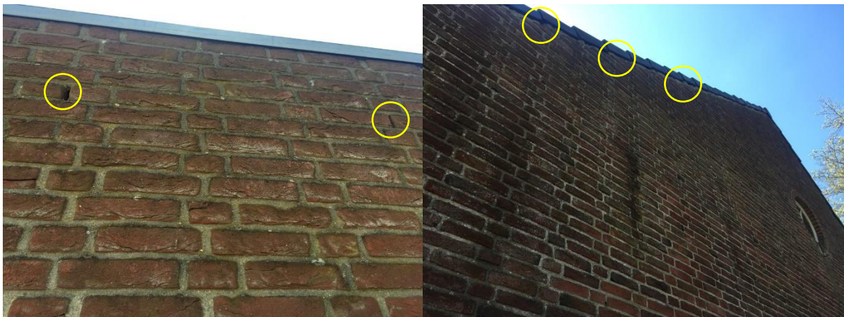
Foto links; er zijn openstootvoegen in de buitengevels van de bebouwing vastgesteld (gele cirkels). Foto rechts; er zijn openingen vastgesteld onder de gevelpannen (gele cirkels).
