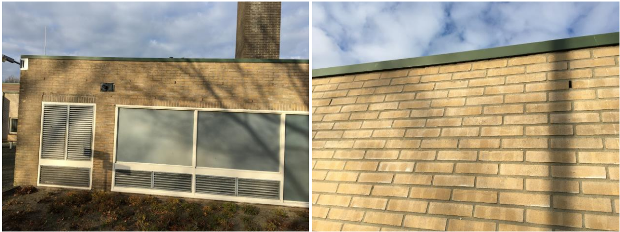
Detailopname van de buitengevels. Op de foto's zijn open stootvoegen duidelijk zichtbaar.
