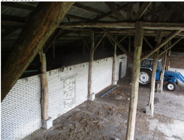
Overkapping bestaat uit hout en AC golfplaten.
