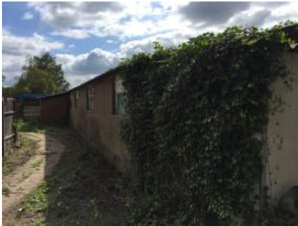
Klimop aan één van de varkensstallen; deze klimop vormt een potentiële nestplaats voor vogels.
