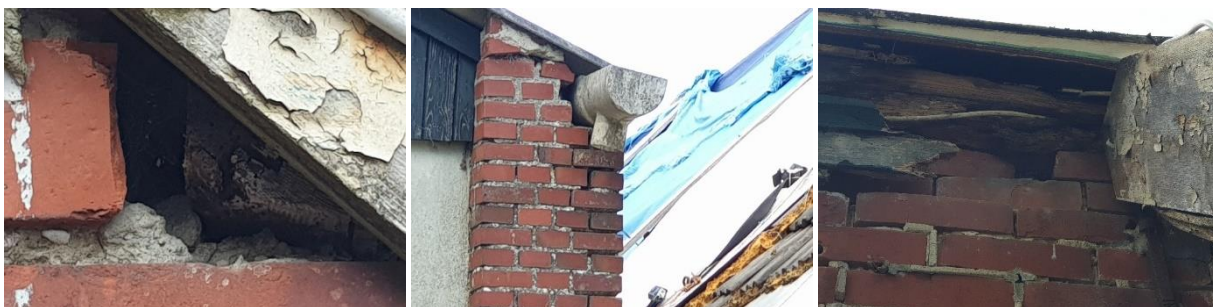
Figuur 15 Potentiele invliegopeningen voor vleermuizen bij afbrokkelende metselwerk (links en midden) en rottend hout (rechts) langs de dakrand.
