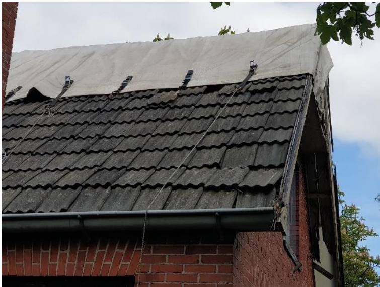
Figuur 12 Het dak van Gebouw 1 verkeert in een zeer slechte staat van onderhoud.
