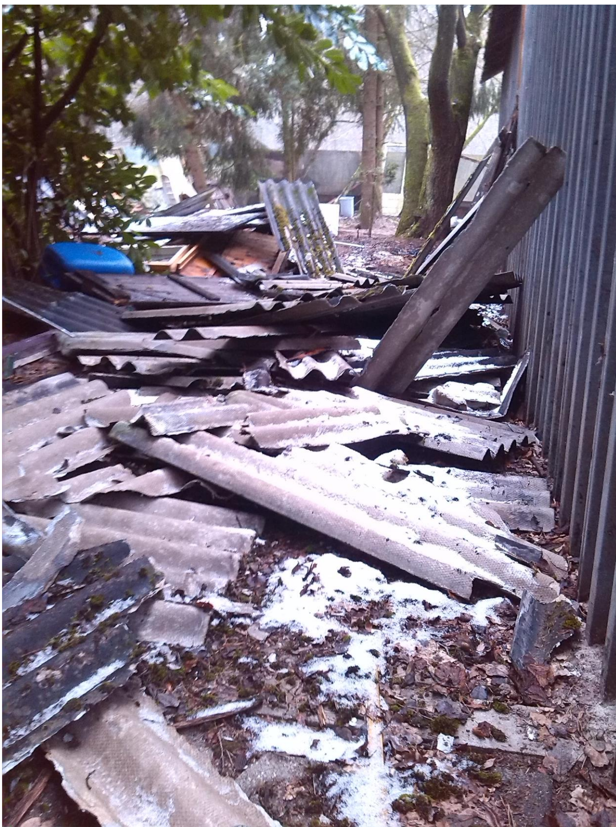
Foto 5: restanten asbestverdacht golfplaat bij werkplaats 3
