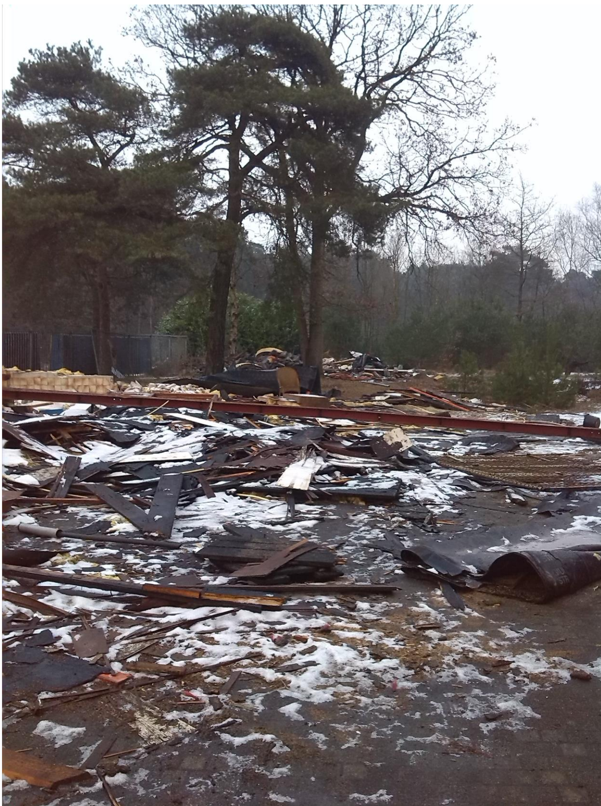
Foto 7: afval opslag en deels afgebroken bebouwing
