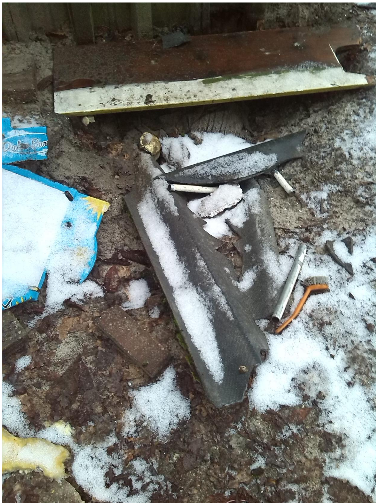
Foto 4: restanten asbestverdacht golfplaat bij werkplaats 3
