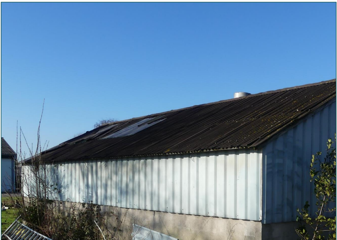
Figuur 4 Impressie van het dak van de schuur. Aan de linkerzijde is de beschadigde dakbedekking zichtbaar.
