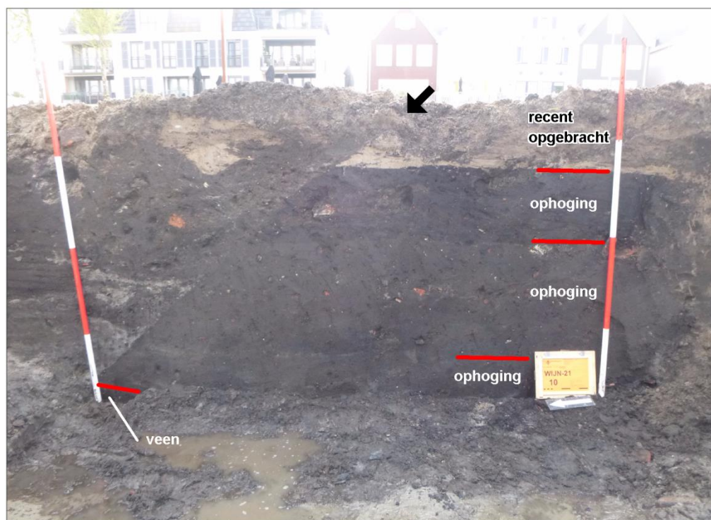
Afb. 9. Het meest noordelijke deel van de opgraving is tot grote diepte recent geroerd door de aanleg van meerdere diep gelegen leidingen (vanaf de zwarte pijl naar onderkant jalon).
