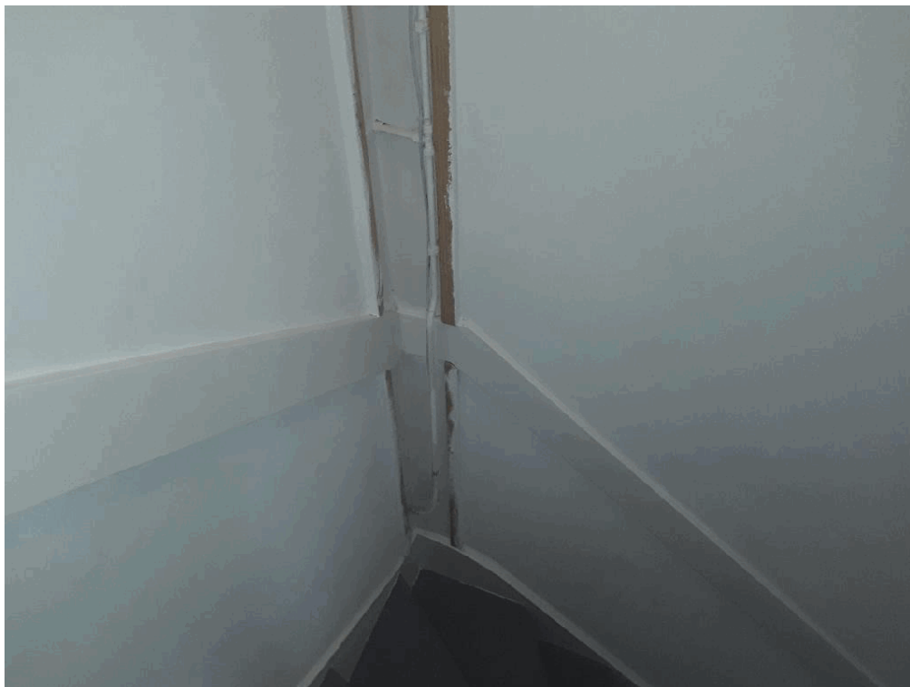
Verwarmingsbuis in de schacht op de trap.
