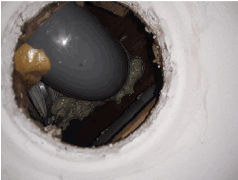
Ventilatiekanaal vanaf badkamer pvc en flexibele buis.
