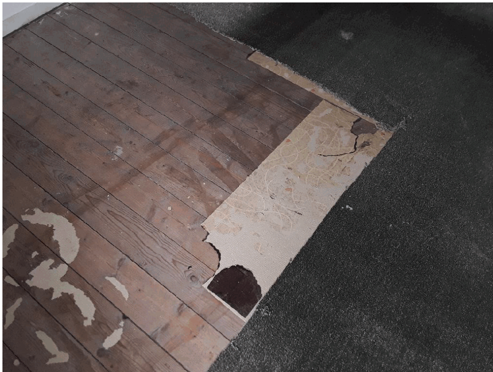
Geen verdacht vloerzeil bij nr 5 onder het tapijt.
