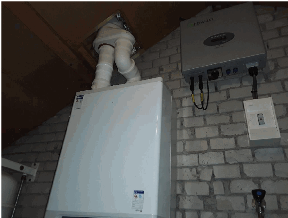
Geen verdachte cv-ketels of brandwering boven de ketels.
