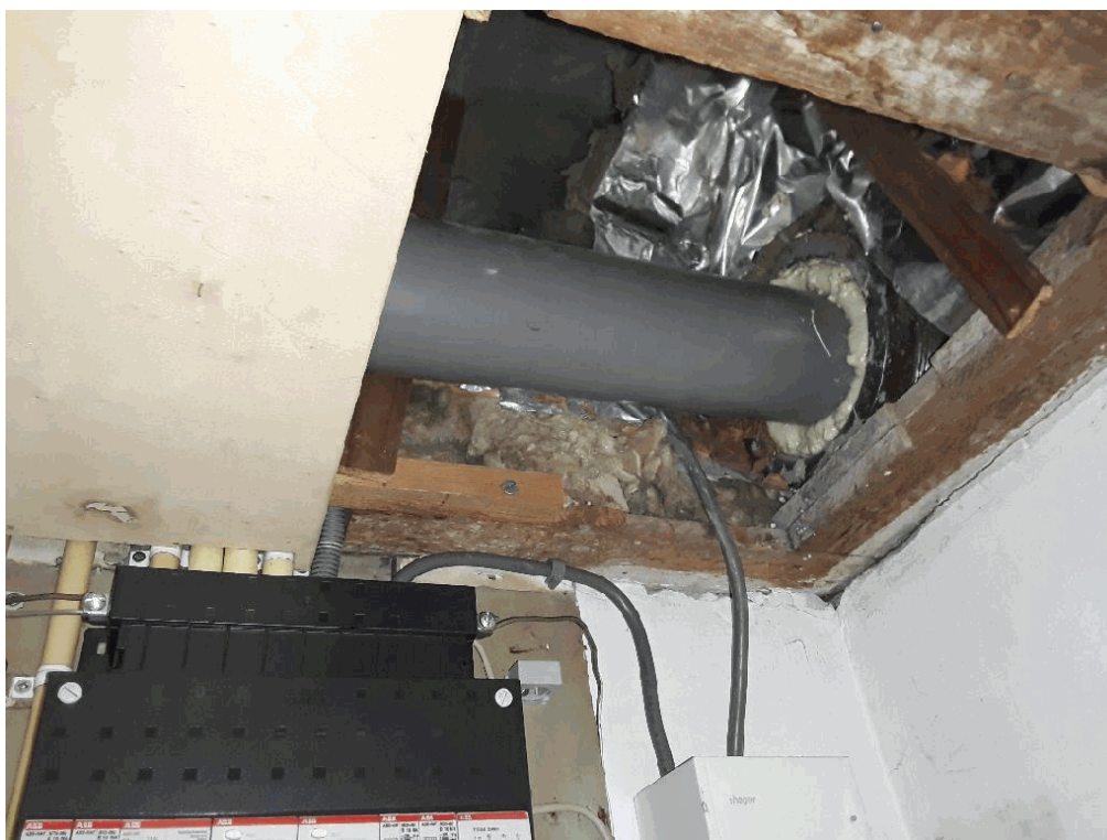
Pvc ventilatiekanaal vanaf toilet naar buiten. nr 14
