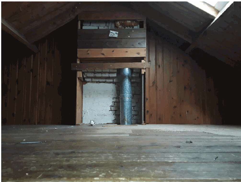
Stalen ventilatiekanaal in de schacht op zolder.
