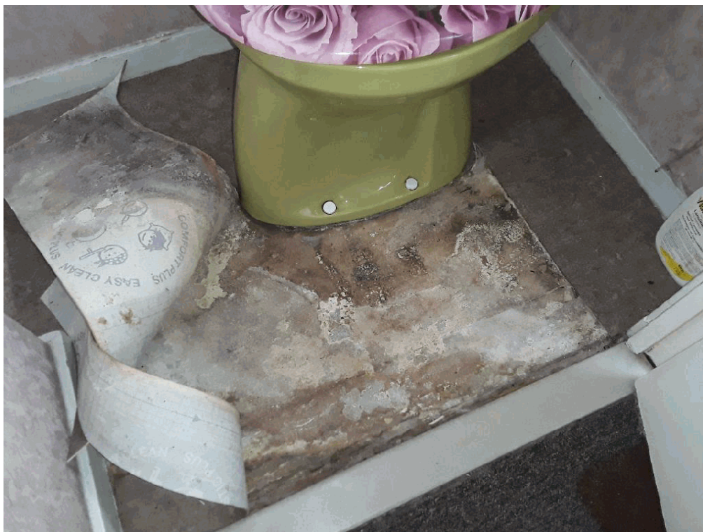
Geen verdachte vloerafwerking in het toilet onder het niet verdachte zeil.
