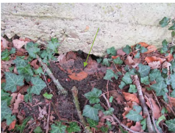
Verdachte ruimte onder funderingsplaat aan zuidzijde bijgebouwen
