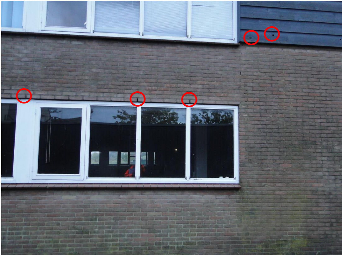
Figuur 7: Open stootvoegen en gaten (rood omcirkeld) in de gevel van de te slopen bebouwing
