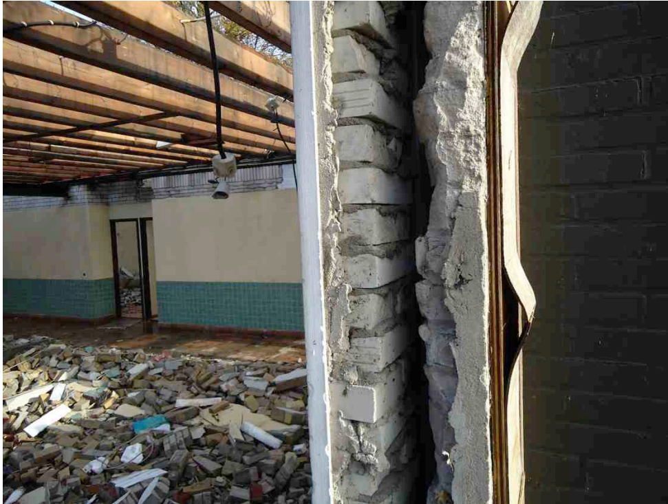
Figuur 3.5 Opeengebroken spouwmuur nabij hal B.
