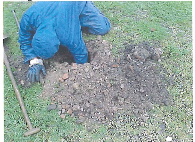
Foto 10: Puin verharding op achterterrein
