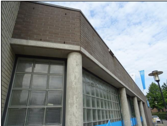
Figuur 15. Open stootvoegen in noordelijke gevel.
