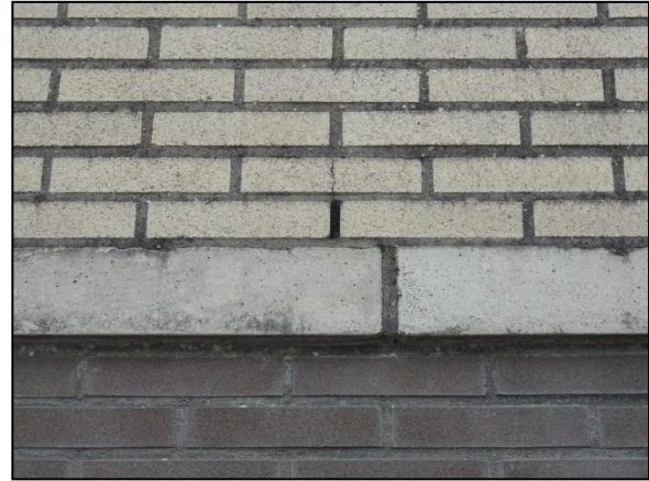
Figuur 13. Open stootvoeg in westelijke gevel
