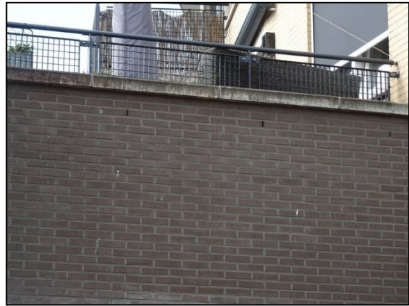
Figuur 168. Open stootvoegen in het lagere deel van het appartementencomplex ten zuiden van de onderzoekslocatie.
