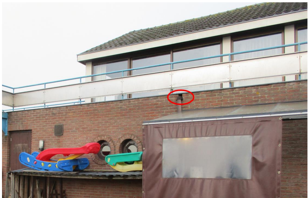
Figuur 4 De opening bij de hemelwaterafvoer is ontoegankelijk doordat de regenpijp de toegang blokkeert.
