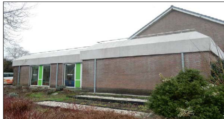
Figuur: zuidwestelijke gevel van het te slopen pand waar open stoot voegen in aanwezig zijn (zie onderstaande foto).
