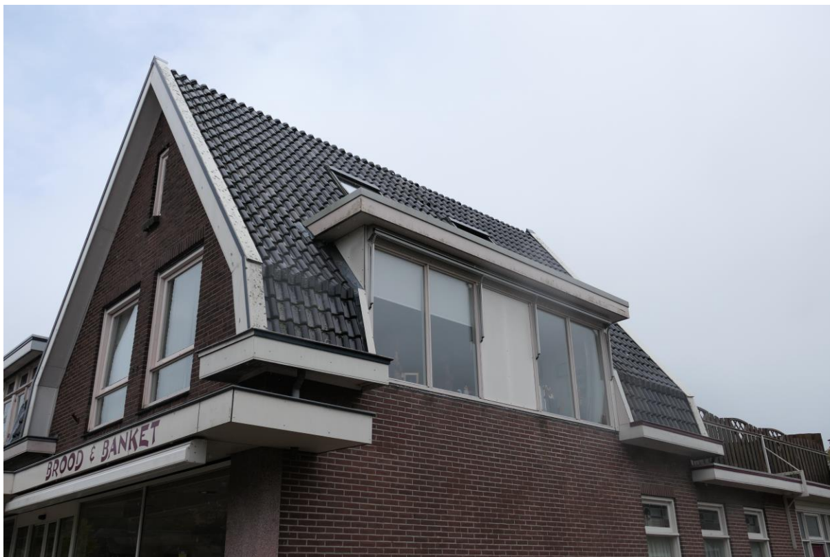
Afbeelding 4.3.1 Geen losliggende dakpannen.
