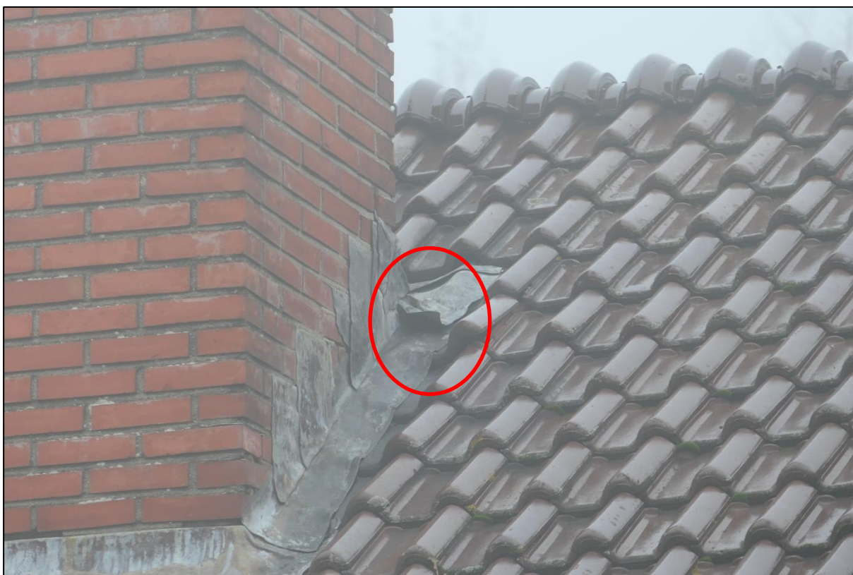
Figuur 4.14 Losse loodflap op het dak van de Boerhoorn biedt mogelijk zomerverblijfplaats voor kleinere vleermuizen en gierzwaluw.
