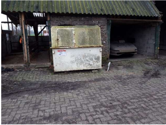
Bovengrondse dieseltank bij noordelijke loods
