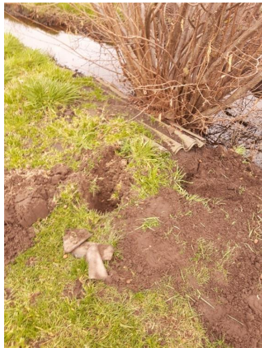
Asbestverdachte plaat gedeeltelijk in de grond en gedeeltelijk aan maaiveld, westelijk van de sloot t.p.v. Haakswold 11
