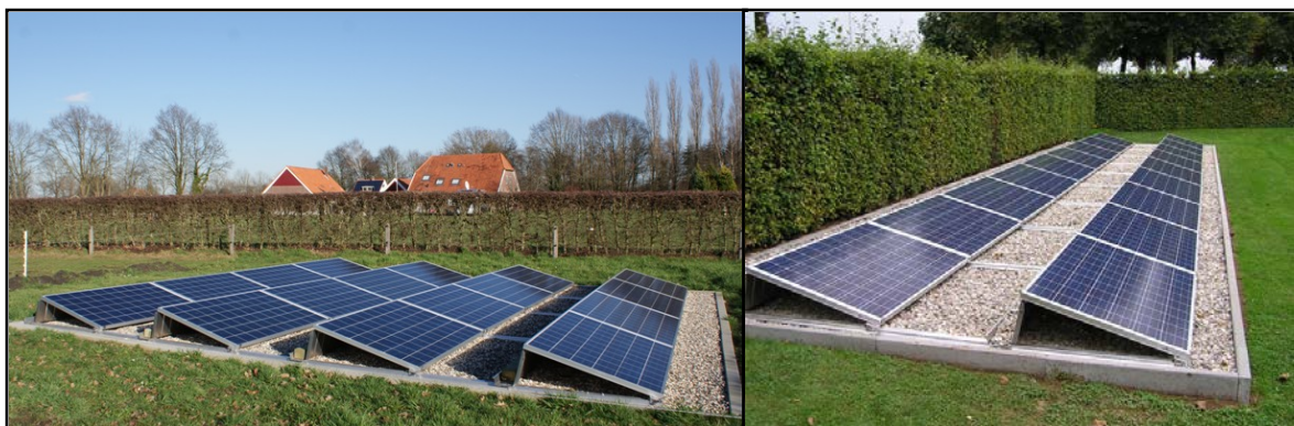
Afb. 9 & 10: Zonnepanelen in de tuin, binnen het bouwblok
