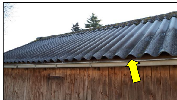
Figuur 10. Geschikte ruimte voor huismussen onder de golfplaten.
