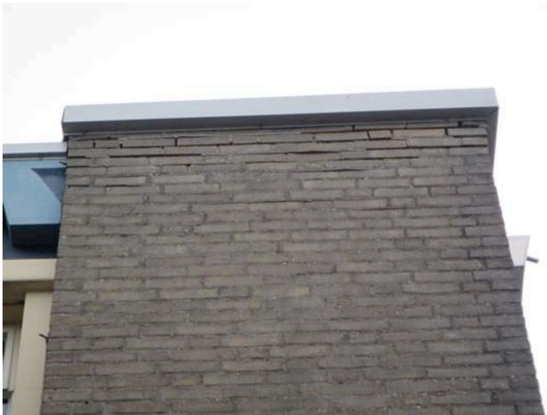
Figuur 5 Beschadigde voegen.
