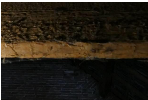
Figuur 34 – De brandmuur vanuit de stal. In het midden, onderaan de vlechtingen.
