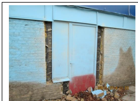
Foto 14: Door sloop open gehakte spouwen naast deur/vensterkozijn van het schoolgebouw.
