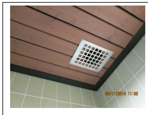
Foto 10: Met rooster afgesloten ontluhtingskanaal in gymnastiekgebouw.
