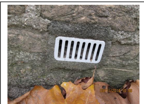
Foto 11: Ventilatioerooster zijgevel schoolgebouw.
