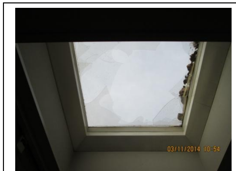
Foto 12: Door sloop gebroken daklichtkoepel schoolgebouw.
