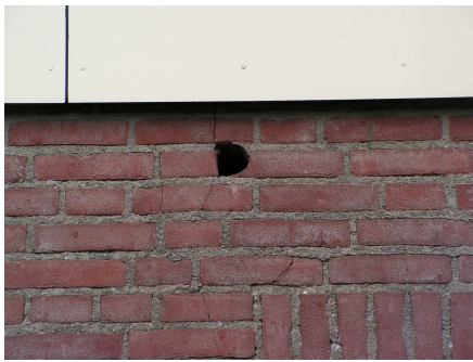
Zuidmuur kantine met groot gat naar spouwmuur.
