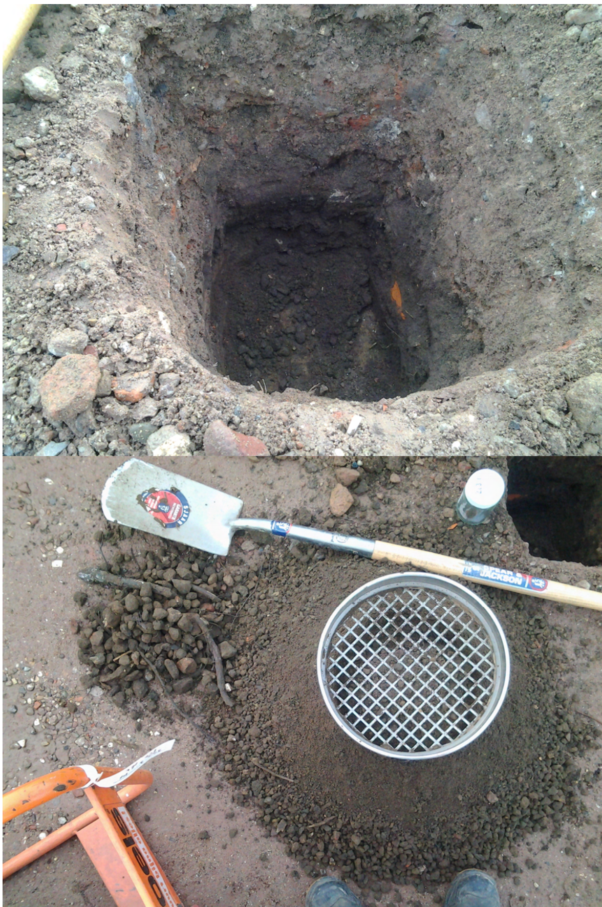
Foto's van asbestgat 223 – 21 januari 2015
