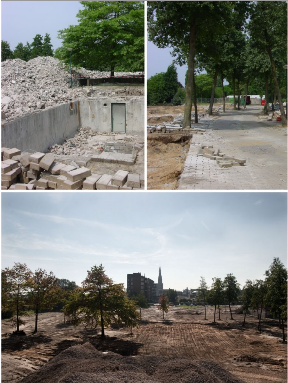
Figuur 29. Drie foto's van het plangebied tijdens (foto's boven) en na (foto onder) de sloop van de woningen aan de Lage Weidjes. Onder is te zien hoe het plangebied na de sloopwerkzaamheden eruit zag. Bron: Mooiland Vastgoed.
