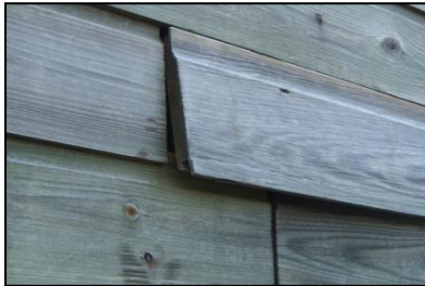
Figuur 9. Loshangende betimmering.
