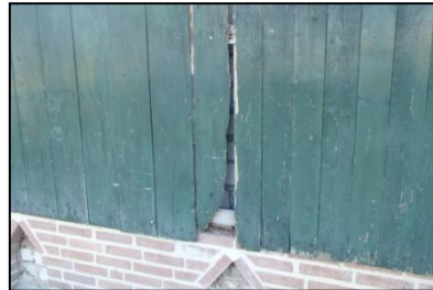
Figuur 10. Beschadigde betimmering.
