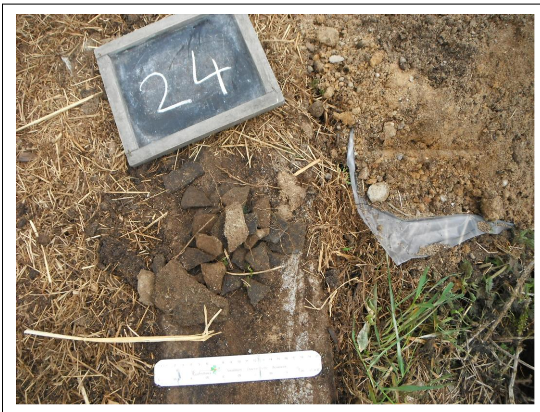
Aangetroffen asbestverdacht materiaal (ASB-2 en ASB-3) ter plaatse van gat 24.
