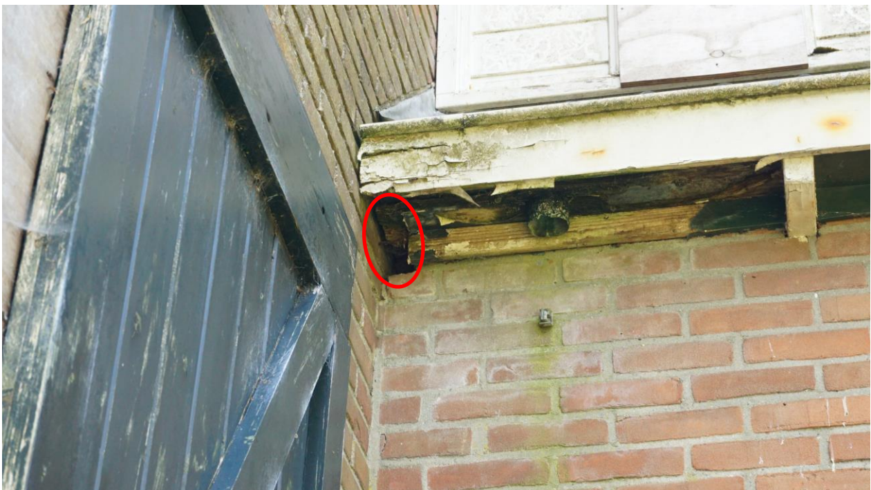
Figuur 4.10 Bij rottende overstekken is ruimte aanwezig voor vleermuizen om de spouw of het dakvlak te bereiken.
