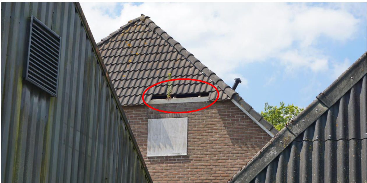
Figuur 4.5 Ontbrekende dakpannen op het woninggedeelte van Nuisveen 1 bieden ruimte voor gierzwaluw om onder het dak tot broeden te komen.
