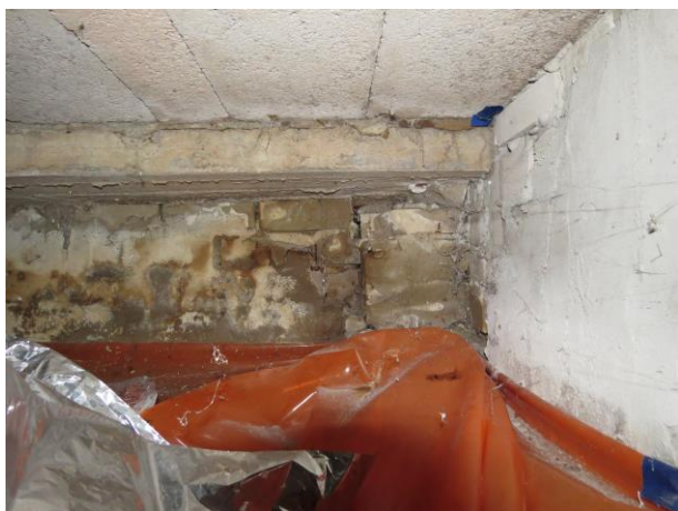
Figuur 24: natte funderingsmuren in kruipruimte
