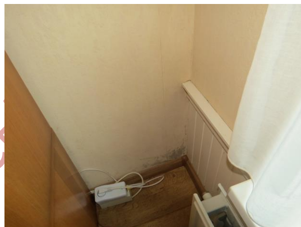
Figuur 22: Jan Fabriciusstraat 2 schimmel inwendige hoek zijgevel/voorgevel/begane grond vloer
