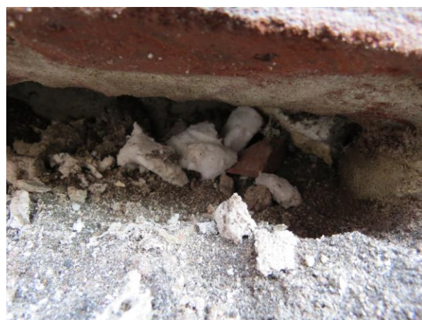
Figuur 11: open gemaakte zijgevel Anne de Vriesstraat 42, restanten verpulverd UF schuim in combinatie met zand
