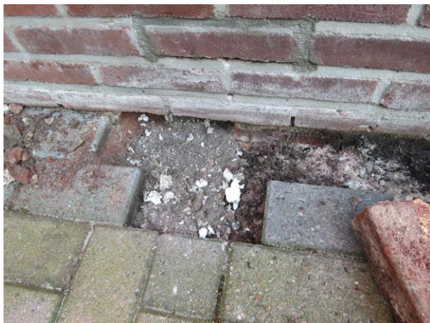
Figuur 12: boven aanzicht open gemaakte gevel, verpulverd en restanten UF schuim
