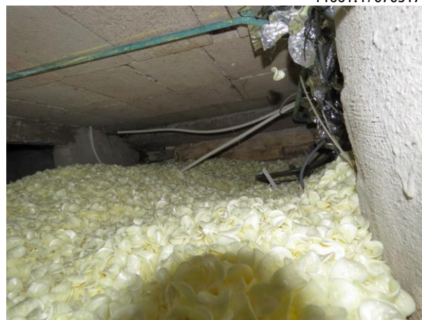
Figuur 26: drowa en natte funderingsmuren in kruipruimte
