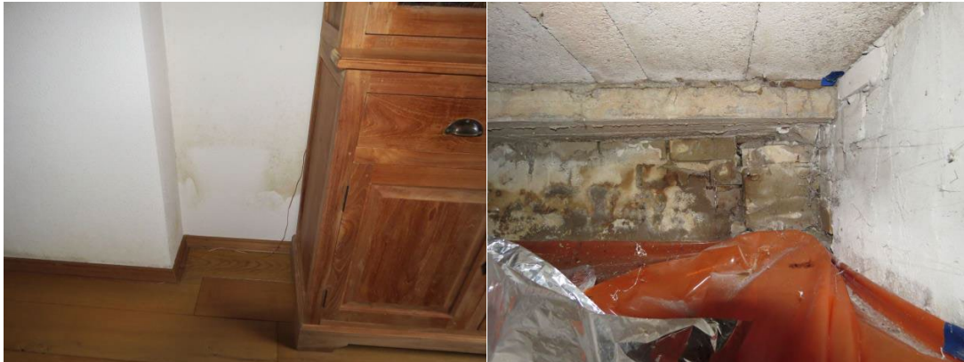
Figuur 7.1 Schimmel in woning (links) en natte funderingsmuur in kruipruimte (rechts) in onderzochte projectwoningen ( Fysi-K, 2017).
