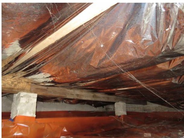
Figuur 25: natte funderingsmuren in kruipruimte
