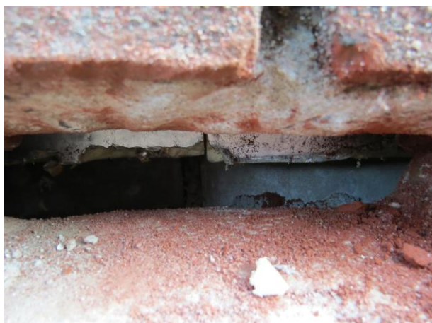
Figuur 13: Jan Fabriciusstraat 2, zijgevel vergeten isolatie ter hoogte van het maaiveld
