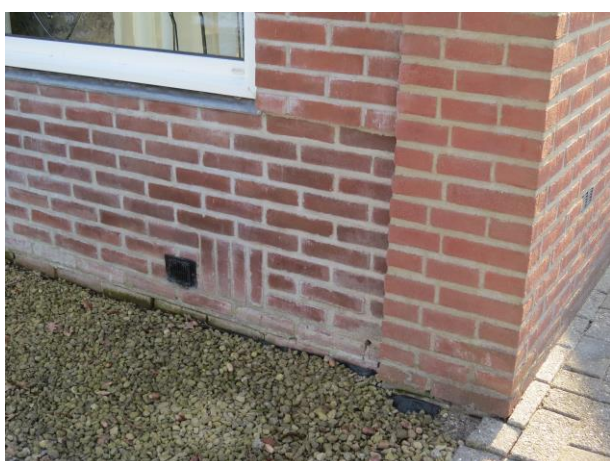
Figuur 8: detail verjonging borstwering en voorgevel, slecht voegwerk en veel zoutbloei
