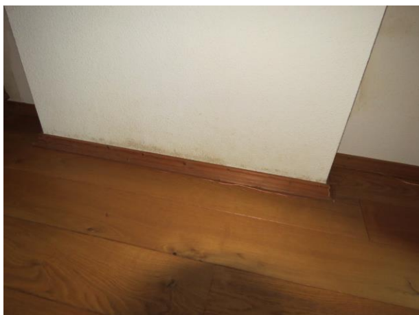
Figuur 18: schimmel bij plint muur schoorsteen
