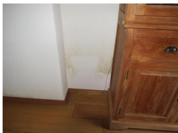
Figuur 17: schimmel op muur bij zijgevel
