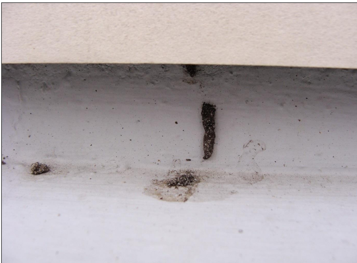
Figuur 12. Vleermuissporen op een vensterbank van de centrale vleugel aan de voorzijde van het zorgcentrum.
