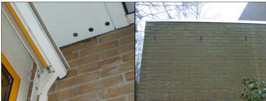
Aanwezige kieren in de bebouwing
