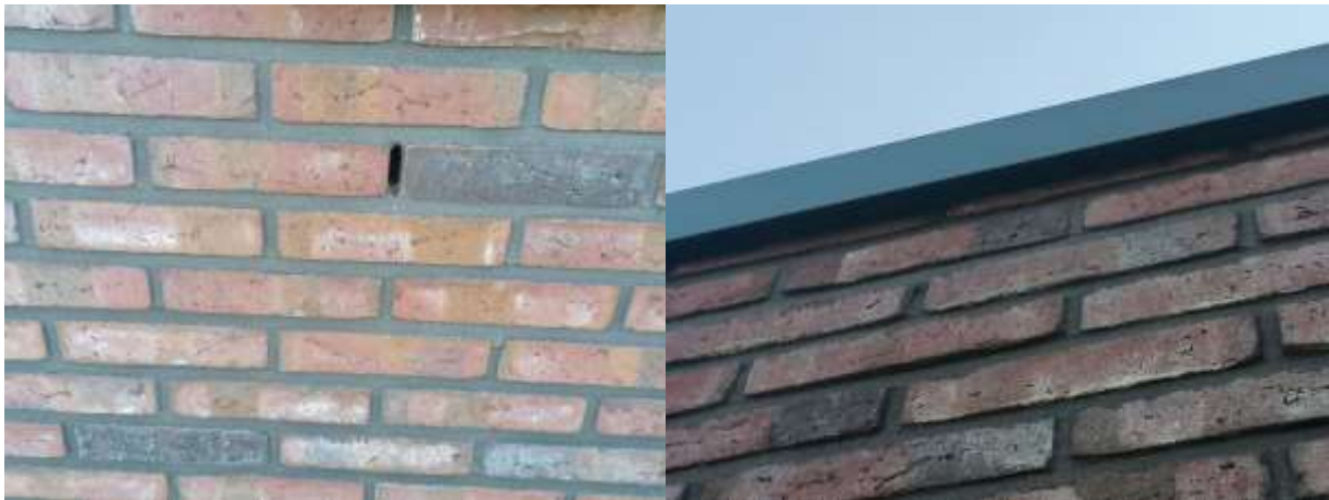
Foto links; Open stootvoeg zit te laag bij de grond. Foto rechts; De metalen daklijst sluit nauw aan op de buitengevel.
